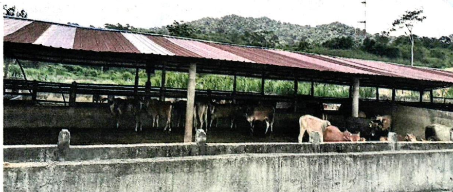
■养牛场2个蓄水池怀疑是山猪挖掘行为导致破裂。(图取自Majlis Perbandaran Kajang)
