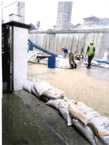
■受工程影響，下大雨時雨水流入民宅。
